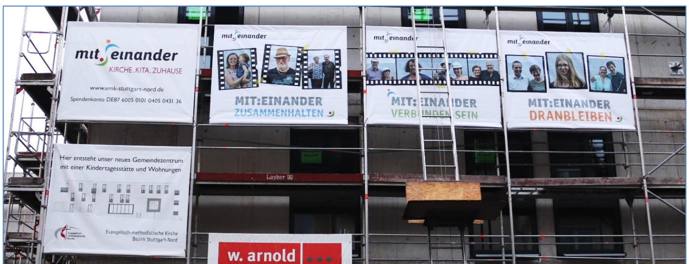
Die Banner am Gerüst in der Burgenlandstraße zeigen, was uns als Gemeinden wichtig ist: miteinander zusammenhalten – verbunden sein – dranbleiben.
