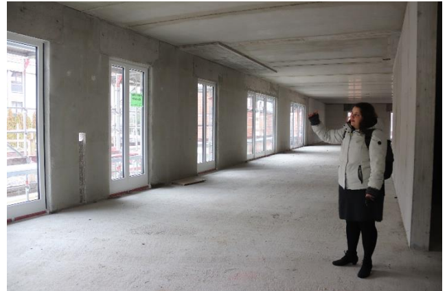
Ende Januar war noch keine Wände zu sehen, inzwischen sind hier die Kita-Räume im Erdgeschoss entstanden.
